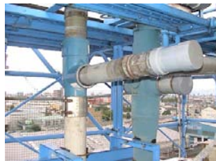
9F 配管状況
