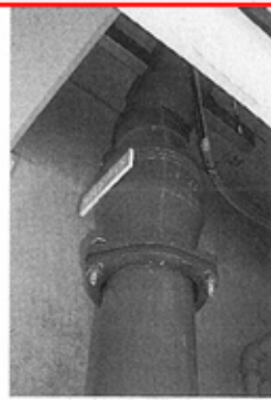
共用排水立て管上部に設置された「やりとりソケット」
