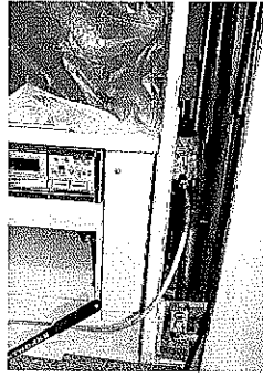
「新JUST工法」の開発で、わずか18cmしかない狭いスペースでも更新工事が可能となった
